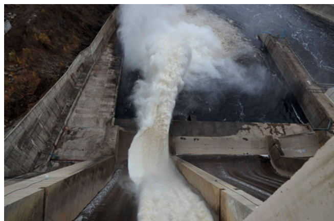
Рис. 4. Общий вид струи при работе пролёта № 7 и открытии его затвора на 1,5 м и полностью закрытом затворе пролёта № 8
